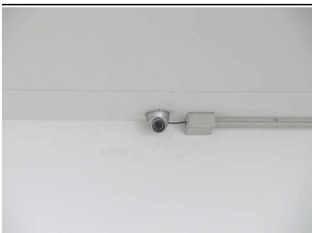
Foto 7 Telecamera di sicurezza
